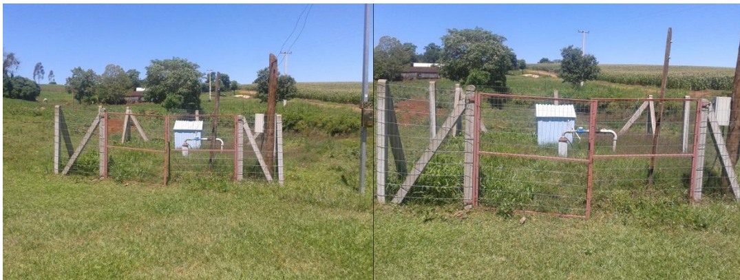
Figura 20: Sistema de abastecimento de água na localidade de Bom Retiro Fonte: Bios Consultoria Ambiental, 2013
