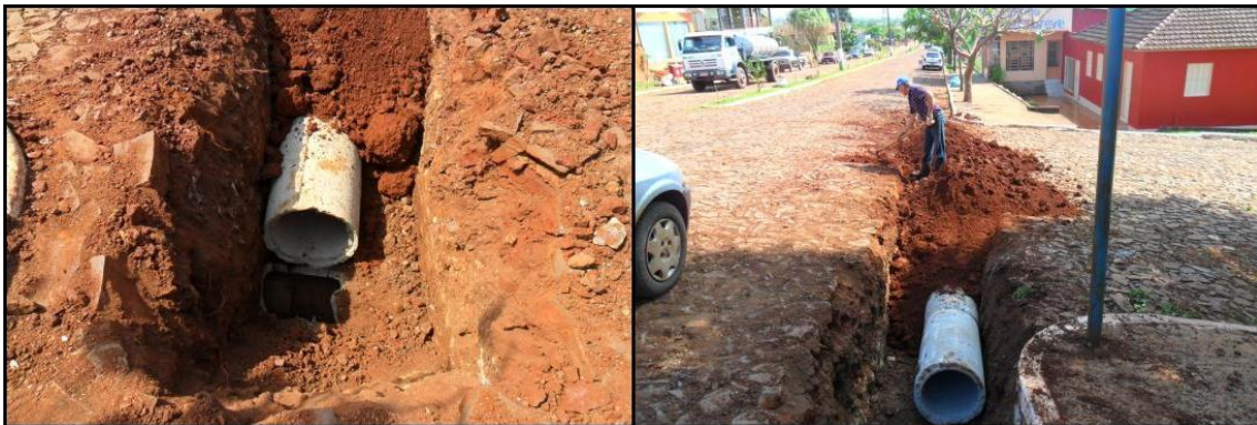
Figura 41: Implantação da drenagem pluvial no município de Tiradentes Fonte: Projeto de resíduo sólido urbano do município de Tiradentes do Sul
