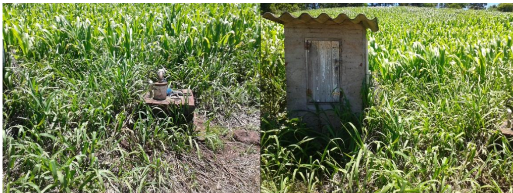
Figura 15: Poço de abastecimento de água na localidade de Esquina Gaúcha
